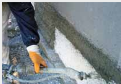
13.00 Uhr – SLP-it. wird aufgespritzt. Als Haftbrücke für den Untergrund wird UNI-H verwendet.
