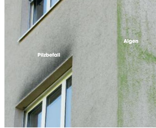
Algen und Pilze an der Fassadenoberfläche
